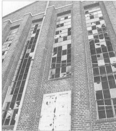
Keinen Respekt vor denkmalgeschützter Industrie-Architektur haben die Steinwerfer auf dem Annapark. Für die Turbinenhalle (Bild) gibt es jetzt offenbar eine gute Zukunft – als Ärztehaus. Foto: Rhein
